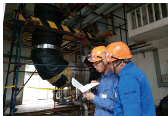
员工对高危作业票证进行检查
